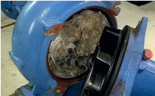
Pumpe in der Kläranlage Schmidmühlen, © Bild: Alexander Bauer
